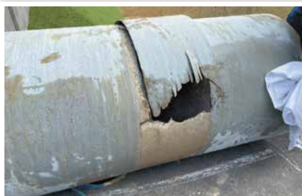
管水路の破損状況
