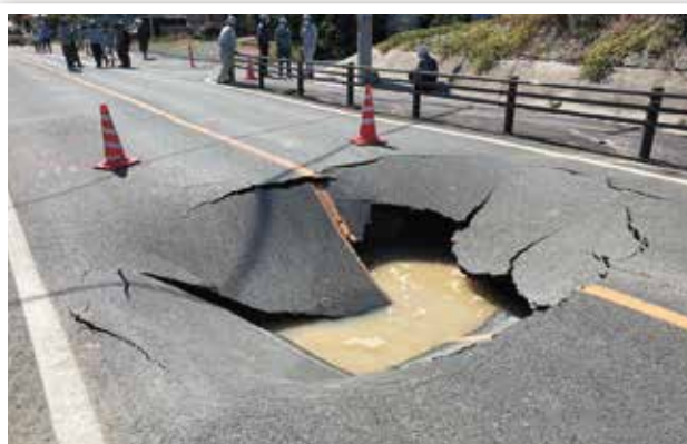
道路陥没状況
