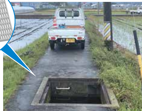
グレーチングの盗難被害状況
